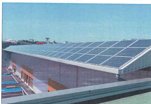
La centrale d'Epinal : des panneaux installés sous forme de brise-soleil.
